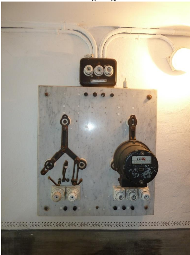
Stromverteiler, Sicherungen und Zähler im Jexhof. Foto: T.Drexler
