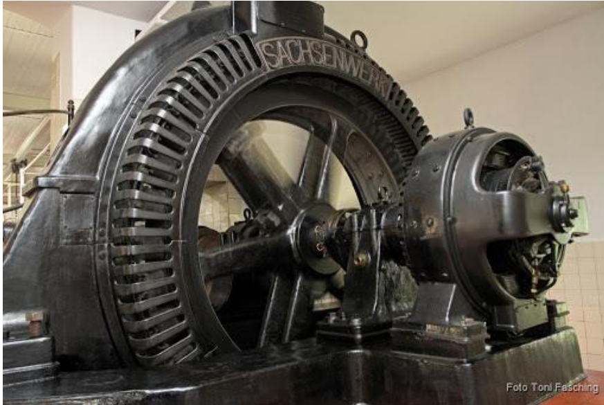
Turbine im Kraftwerk Schöngeising, Foto: T.Drexler
